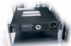
Auf manuellen Bypass umschalten, S1 oder S2.
